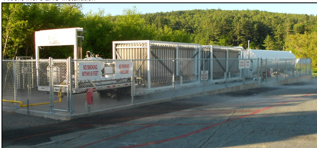
Kleen, Inc.'s LNG Installation
